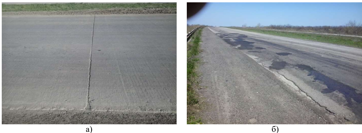
Рисунок 2 – Стан цементобетонного покриття через 70 років експлуатації автодороги Київ – Ковель км. 50+300 (2004 рік): а) ділянка в хорошому стані; б) на високому насипі з поздовжніми тріщинами
